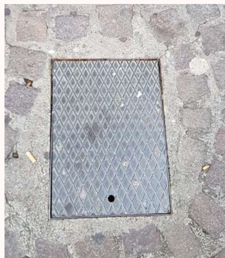
↑ Plaque de bouche incendie
