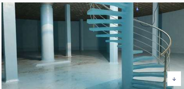
Réservoir de Jouchy rénové ↓
