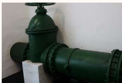
← Station de pompage Mails - St-Égrève
