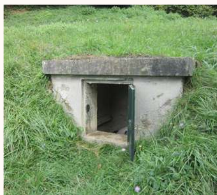
← Captage Matthieu à Séchillienne
